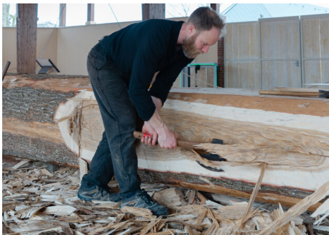
Menuisier-charpentier sur le chantier de la reconstruction de la forge de La Mora à Honfleur © Fondation du patrimoine_MyPhotoAgency_Gregory Gouin
